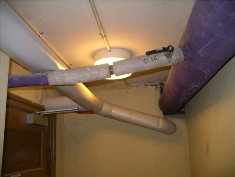
Foto nr. 43. Hovedledninger på loft. Oprindelig varmeledning th. og nyere varmtvandsledning tv. Der er monteret nyere afspærringsventiler.
