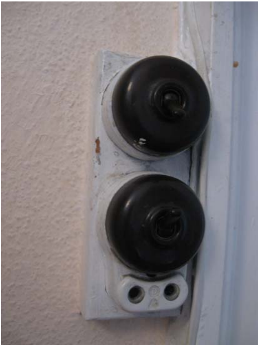
Foto nr. 53. Typisk afbryder og stikkontakt i boligerne.
