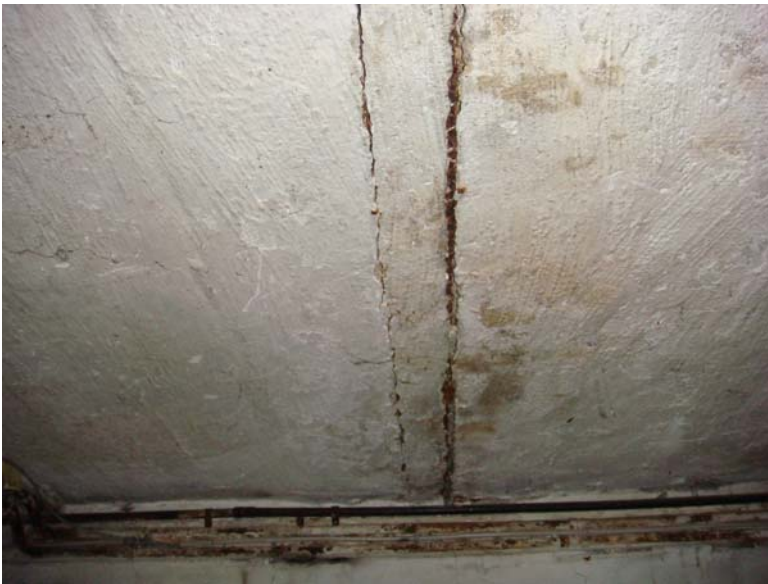
Foto nr. 30. Betonloft i kælder under baderum. Der er tegn på tæring af I-profilerne.
