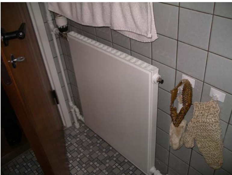
Foto nr. 36. "Ældre" indeliggende pladejerns radiator med termostatventil.
