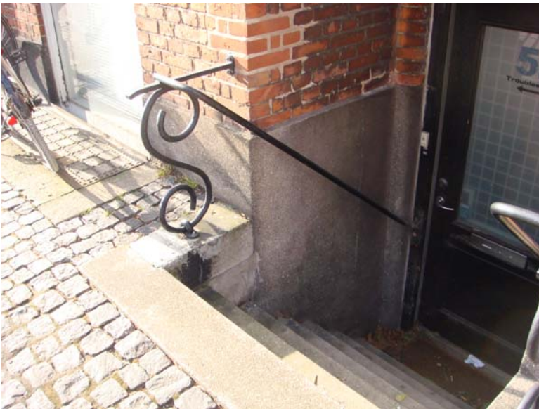
Foto nr. 14. Kældernedgang og lyskasse mod Strandboulevarden. Reparation af murværk ved gelænder.
