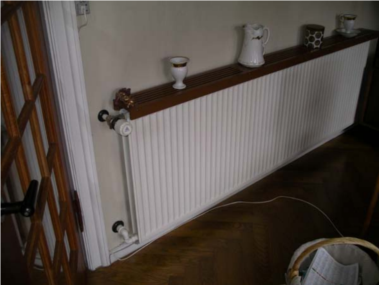
Foto nr. 37. Nyere indeliggende panelradiator med termostatventil.
