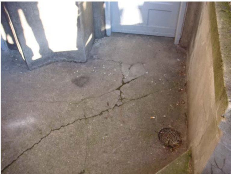
Foto nr. 2. Typisk kælderhals med revner i betonplade.
