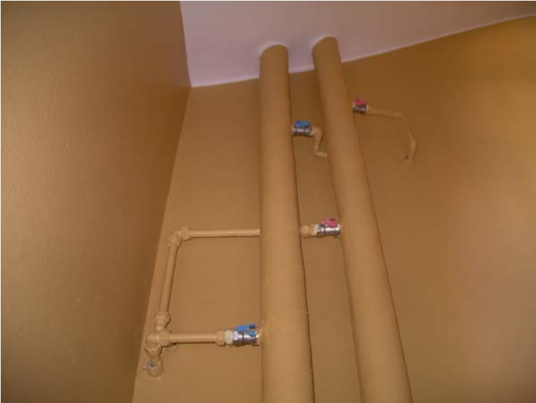
Foto nr. 41. Nyere brugsvandsstigsrenge til baderum placeret på bitrappe. Ionfælder ved overgang til kobber mangler.
