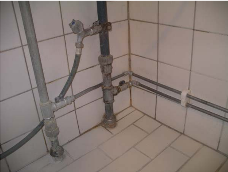
Foto nr. 39. Brugsvandsstigsstreng i bruseniche, Classensgade 52, 1. tv.
