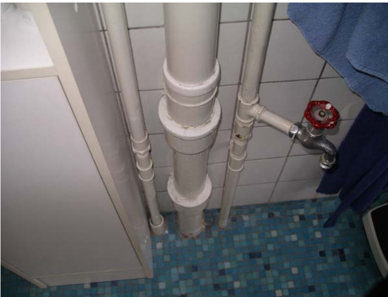
Foto nr. 42. Brugsvandsstigsrenge til køkken placeret i baderum.
