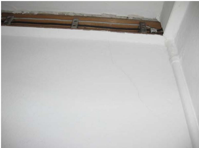
Foto nr. 51. Elinstallationer i boliger. Stofisolerede ledninger i træklemplister under loft i entré.
