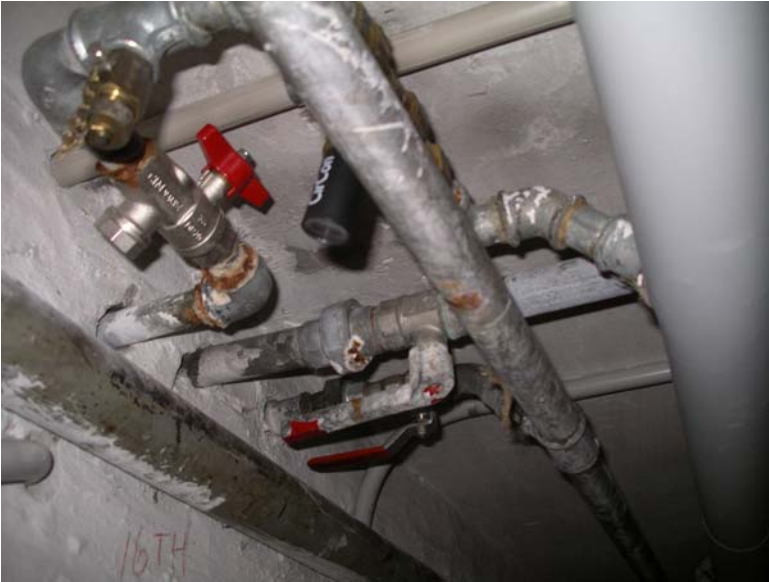
Foto nr. 45. Brugsvandsledninger i kælder. Der ses nyere ventiler og en række tæringer i samlinger.
