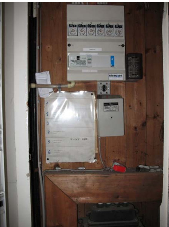
Foto nr. 57. Hovedtavle i opgang, Livjærgade nr. 14.
