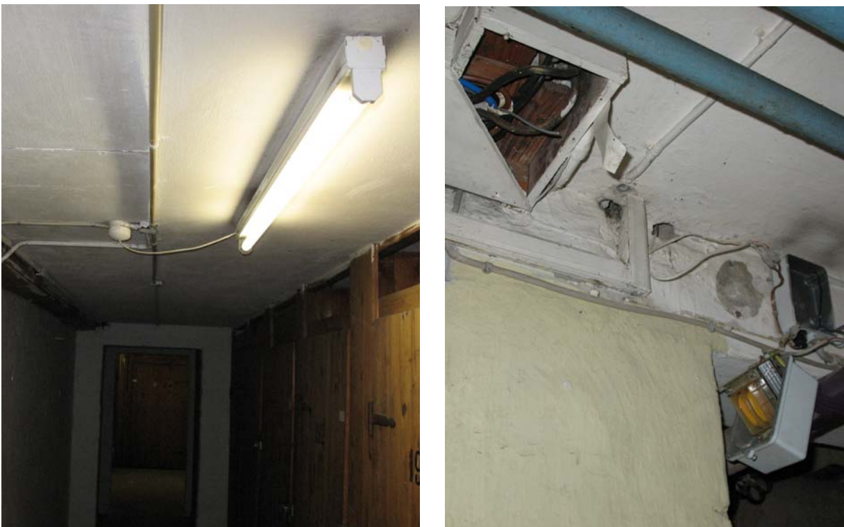
Foto nr. 69+70. Typisk lysarmatur i kælder (tv). Uafsluttede / ulovlige el-installationer i kælder (th).
