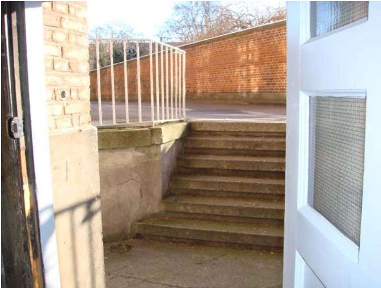
Foto nr. 1. Typisk kældertrappe med revnede trappevanger.
