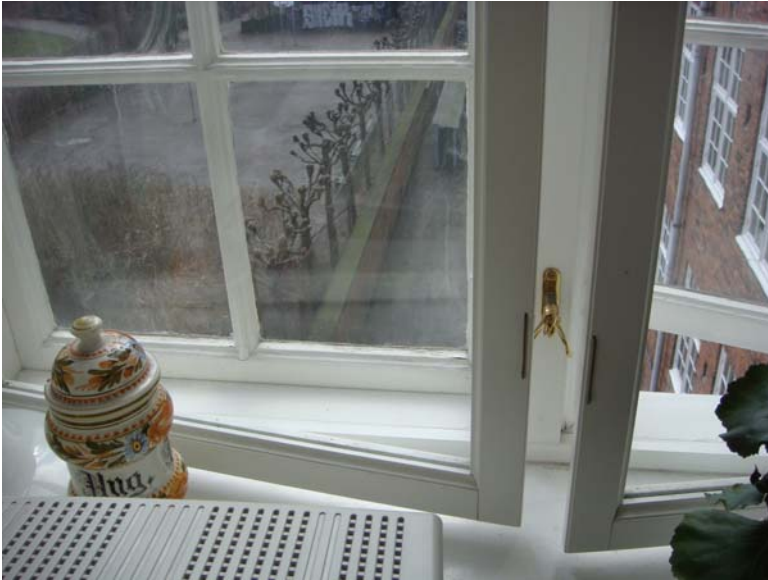
Foto nr. 31. Oprindeligt vindue, forsynet med forsatsrammer.
