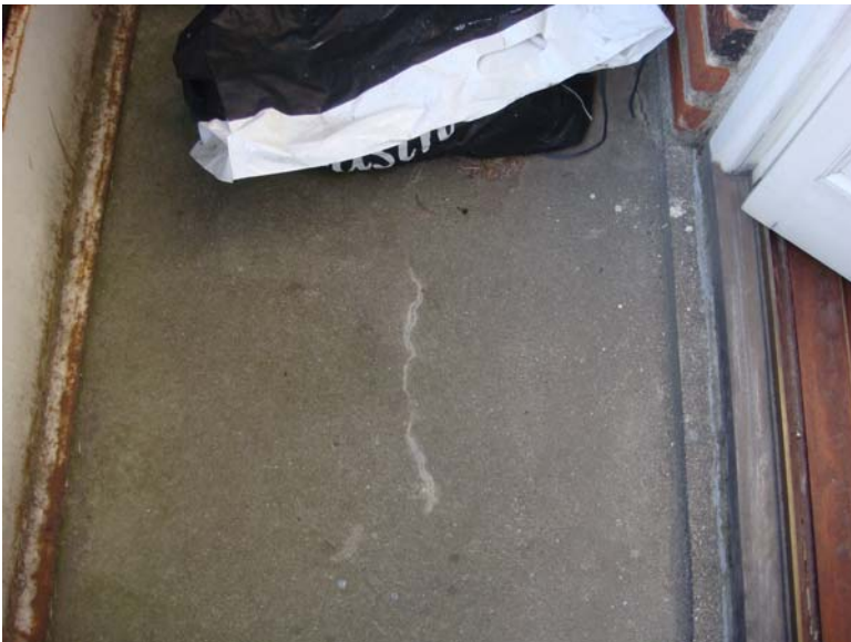
Foto nr. 32. Revne i altanplade.
