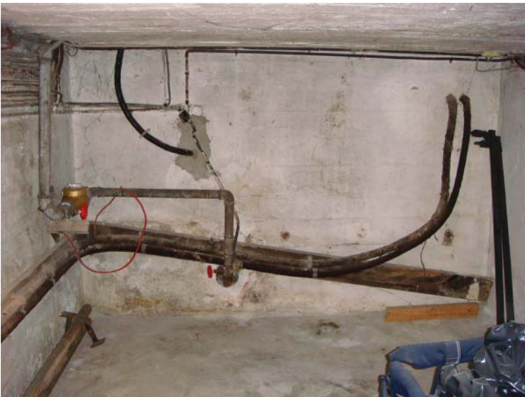
Foto nr. 4. Opfugtet kælderydervæg i undercentral, Afsnit 4 (gulv sænket).
