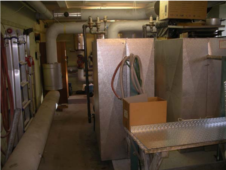
Foto nr. 33. Hovedvarmecentral med pladevekslere i forgrunden.
