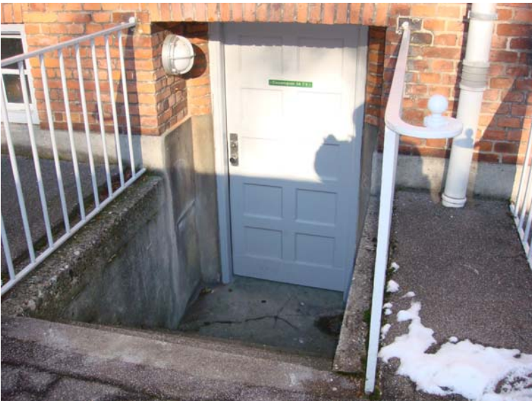
Foto nr. 10. Kældertrappe i gård. Tagedløb ført i jord uden sandfangsbrønd?
