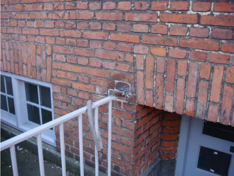
Foto nr. 9. Nærbillede af murværk i gård ved kældertrappe. Skade på murværk ved gelænder.
