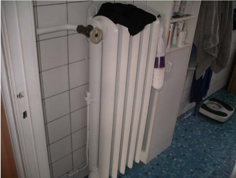
Foto nr. 35. Ældre indeliggende søjleradiator med radiatorhane.
