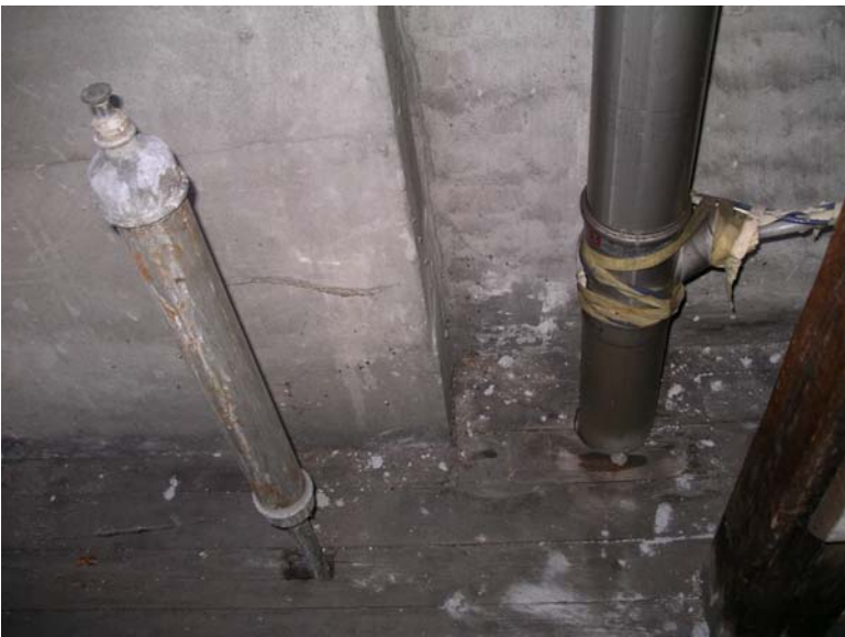
Foto nr. 44. Manuel udlufter på loft, varmt brugsvand (tv). Bemærk plastafløb med varmekabel fastgjort med malertape til faldstamme (th.).
