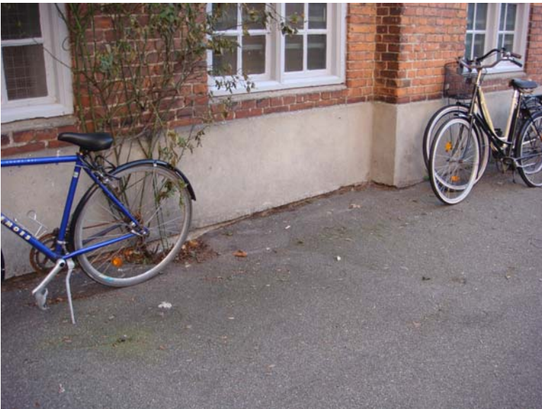
Foto nr. 82. Asfaltbelægning ligger under sokkelpuds. Risiko for opfugtning af kælderydervæg.
