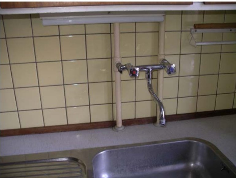
Foto nr. 40. Brugsvandsstigsstreng i køkken, Livjærgade 14, 1. th.
