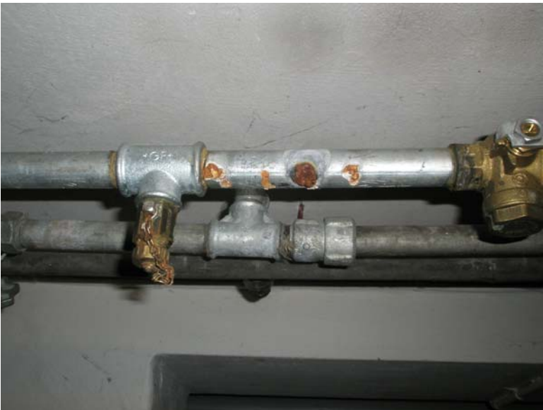
Foto nr. 46. Grubetæringer på tidligere reparation af brugsvandsledning.
