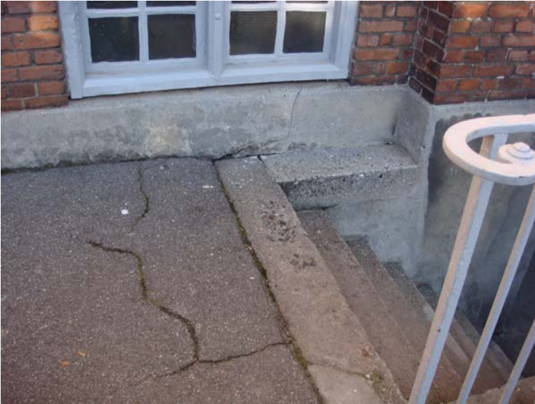
Foto nr. 81. Revner i asfaltbelægning og fald mod kældertrappe.
