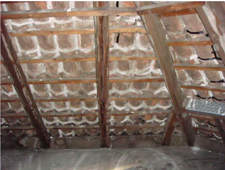
Foto nr. 18. Indvendig tagbeklædning. Der ses flere forskellige reparationer af understrygning samt manglende fastbindinger af tagsten.
