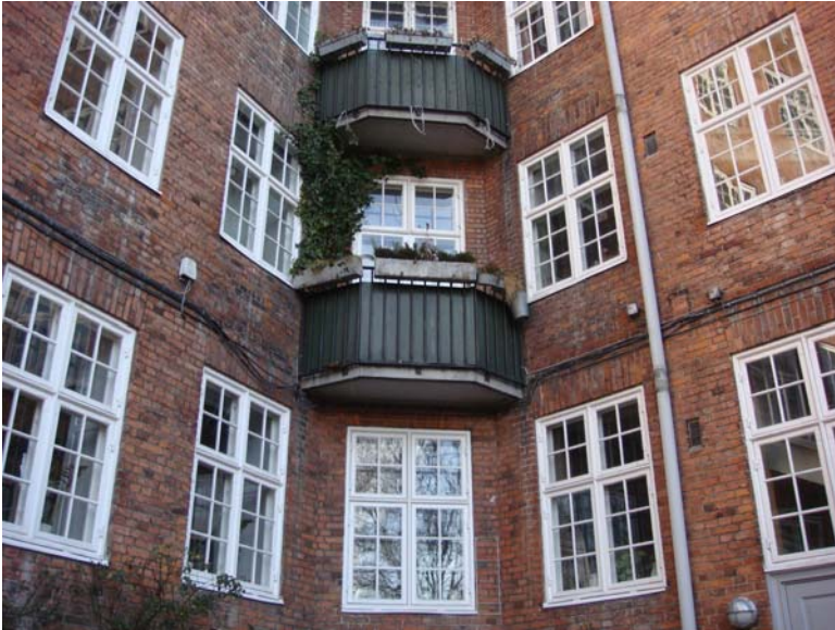
Foto nr. 74. Friskluftriste i facade til svaeskabe i køkkener (ved siden af nedløbet).
