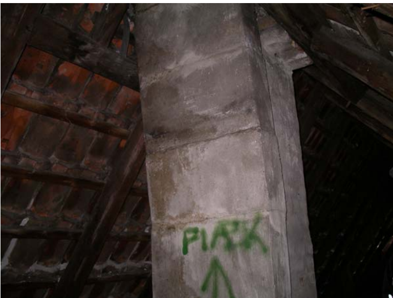
Foto nr. 73. Aftrækskanaler på spidsloft.
