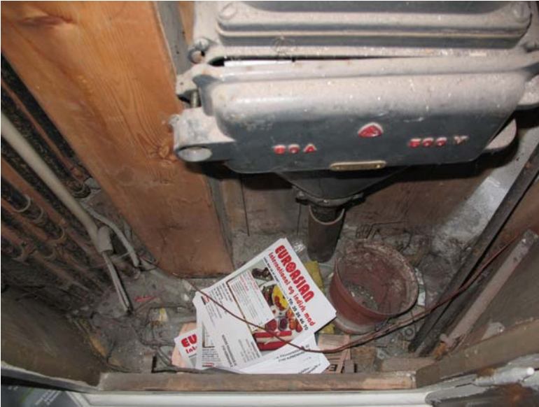
Foto nr. 56. Ældre stofisoleret stikledning og hovedbly, i opgangen Livjærgade nr. 14. Til venstre liggere der stofisolerede ledninger i sorte stålør.
