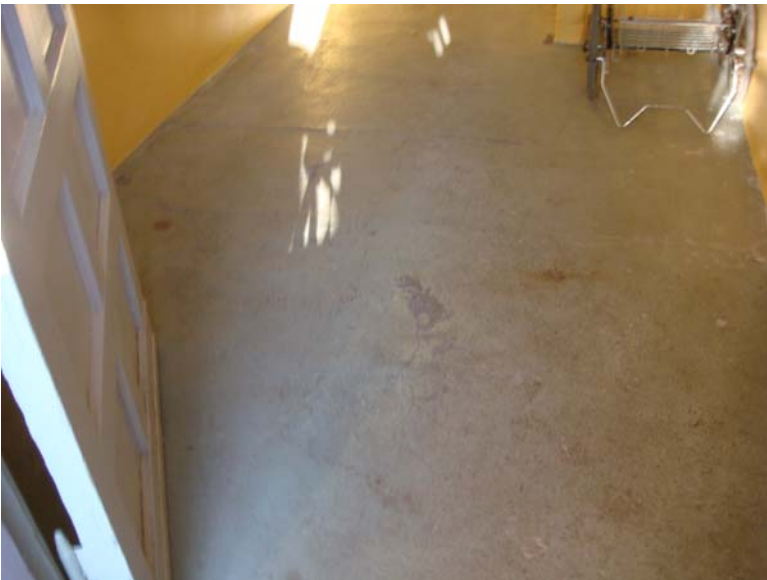
Foto nr. 6. Foto af kældergulv. Der er konstateret mange revner og hule områder.
