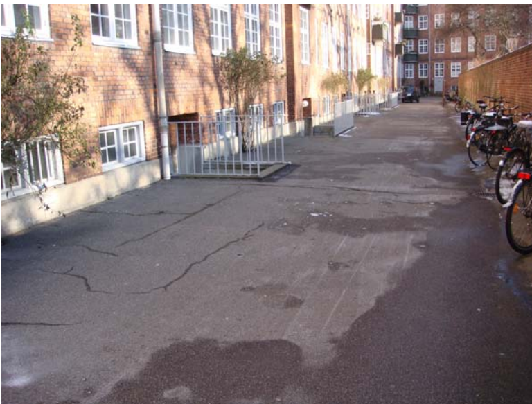
Foto nr. 80. Asfaltbelægning i gård. Mange revner og risiko for vandnedsivning i bærelag.
