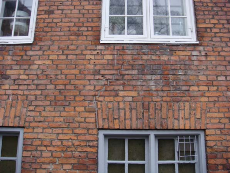
Foto nr. 13. Udsnit af facade ved Strandboulevarden 9. Typiske revner (musetrapper) i murværk over vinduer ved udadgående bygningshjørner.
