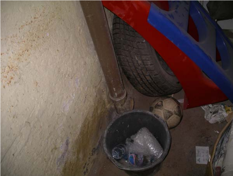
Foto nr. 3. Opfugtet kælderydervæg i undercentral, Afsnit 5 (gulv sænket).
