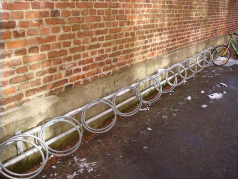
Foto nr. 11. Havemur, revner i sokkel mod gård.
