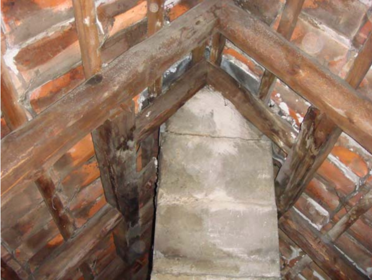
Foto nr. 19. Indvendig tagbeklædning i kip. Træværk ved inddækning af aftrækskanaler synes periodevis opfugtet.
