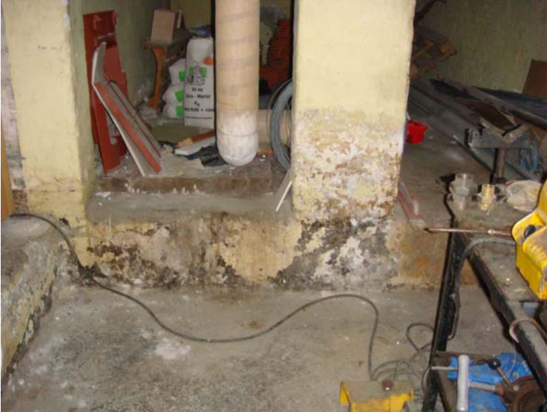
Foto nr. 5. Fugtbelastede indervægge / søjle i undercentral, Afsnit 5.
